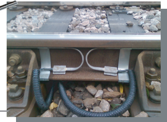
Réchauffage sur appareils de voie du tunnel sous la Manche
